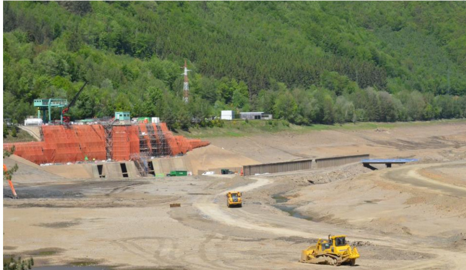
Onze referentie in Coo-Trois-Ponts (België): Waterkrachtcentrale
