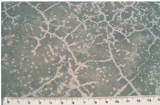
Frühschwindrisse durch Austrocknung der Betonoberfläche
